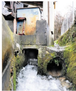
Une fois utilisée, l'eau sort de l'usine et rejoint le ruisseau.
