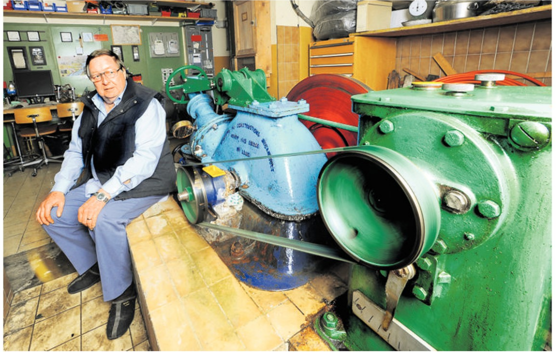
Emile Blaser dans la cave de la maison qu'il loue à Brent, sur les hauts de Montreux. Comme son père auparavant, il assure l'exploitation de la microcentrale et de ses deux groupes turboalternateurs, installés en 1912 et 1914.
